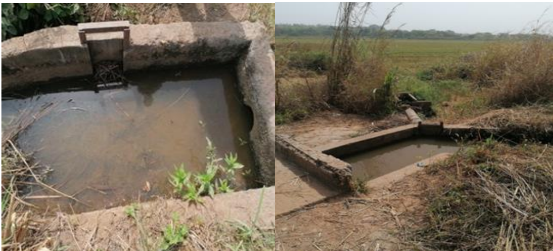
Planche 3-6 : Vues d'une prise parcellaire et d'une prise en tête de canal secondaire – Hambol 13
